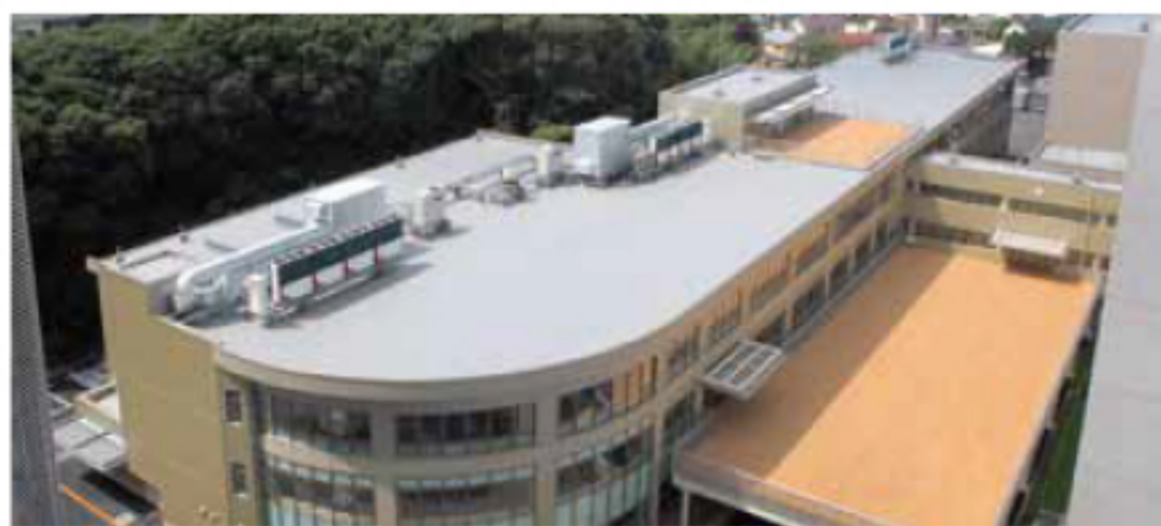
最新式環境配慮・省エネ型の空調システム(屋上)
