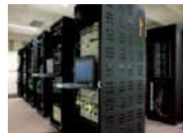
最先端のネットワークを支えるサーバーシステム
