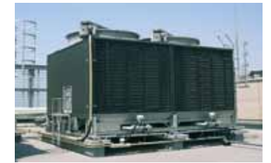
コージェネレーションシステム
